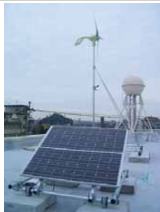
ハイブリッド(太陽光パネル)
